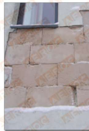
Рис. 16 А. Отрыв штукатурки с высоким сопротивлением влагообмену от влажной кладки.
