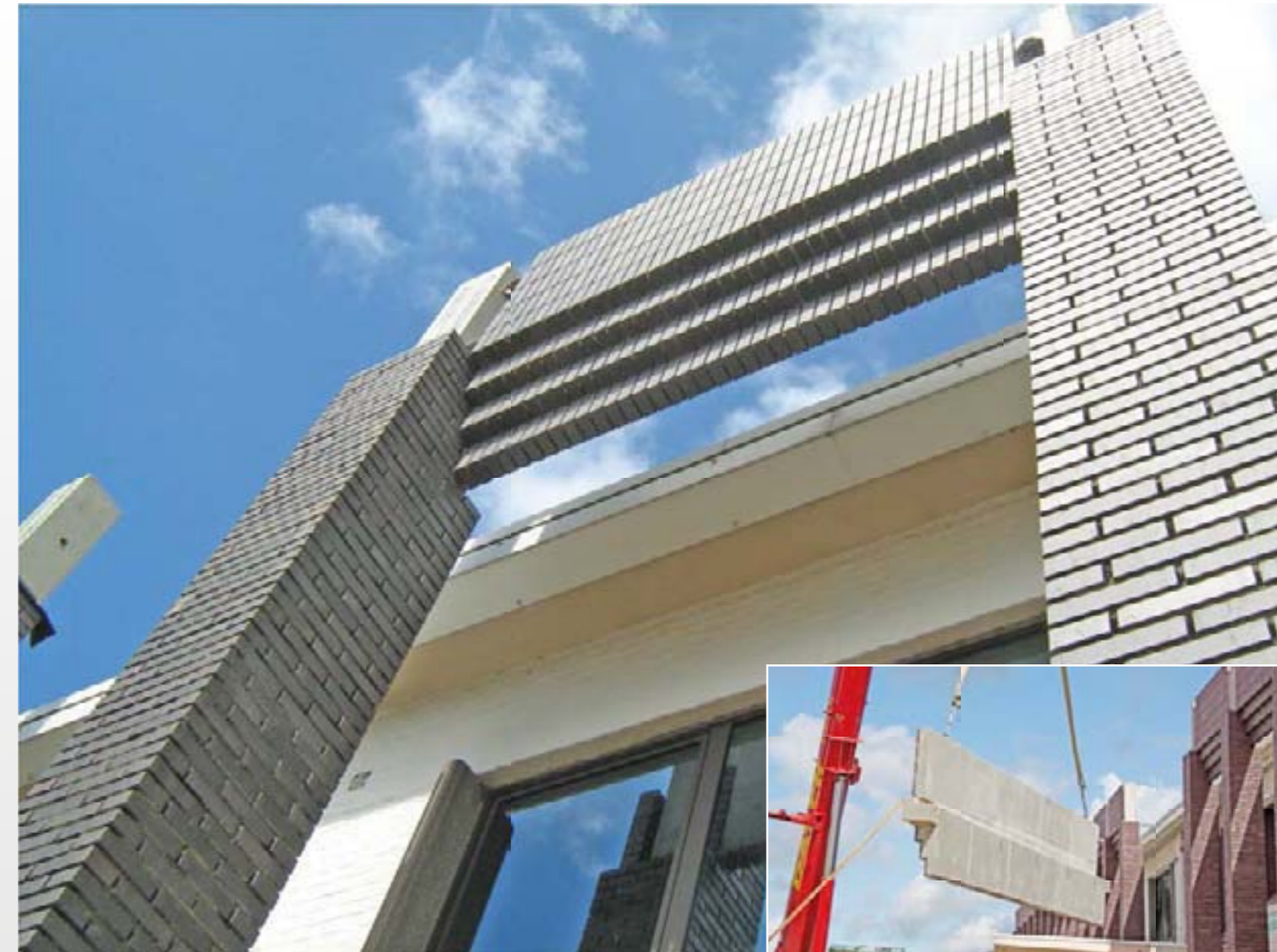
Een nieuwe gevelwand die voor het bestaande gebouw werd geplaatst, bestaande uit peilers in gewapend beton met daar rond conventioneel metselwerk en Röben prefab-elementen in trapvorm, bekleed met gevelsteenstrippen.
