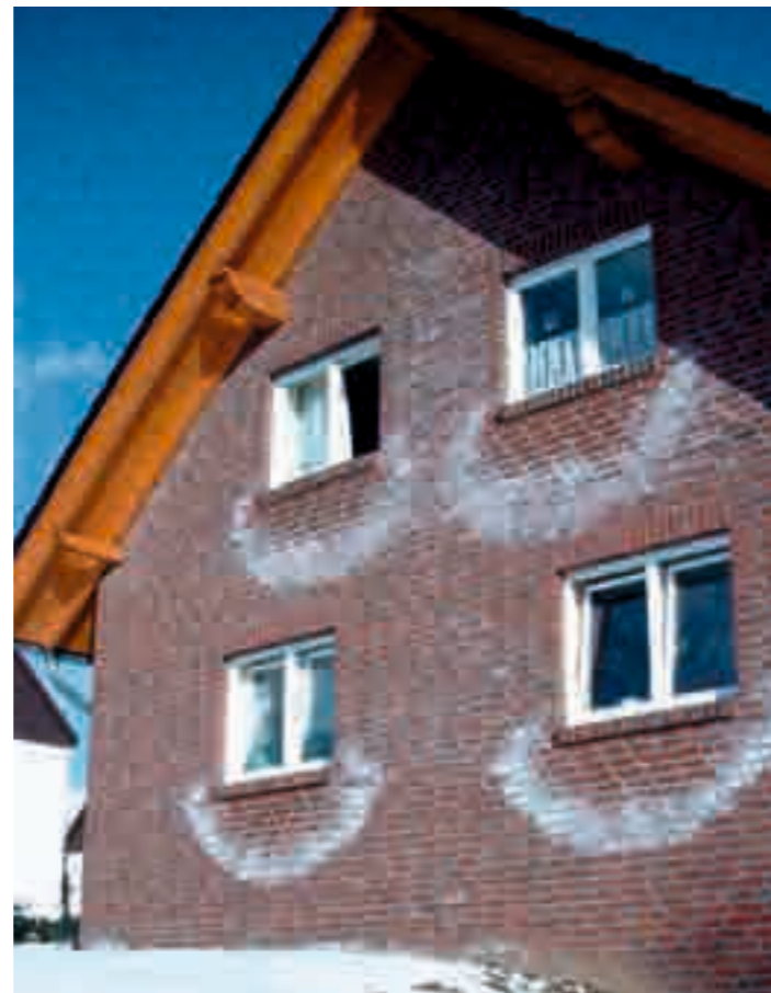
Ausblühungen (hier im Bild die sogenannten „Wassersäcke“), entstanden durch Regenwasser, das durch die konventionell gemauerten Fensterbänke in das Mauerwerk eingedrungen ist.
